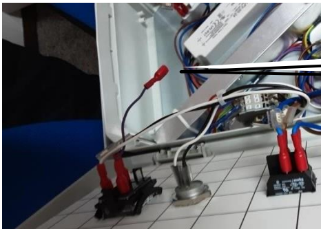
Betriebsstundenzähler und Faston
